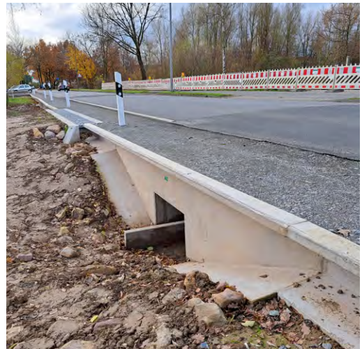
Abb. 2: Eine weitere dauerhafte Schutzanlage am Horstheider Weg mit Tunnel, Leitsystem und Auffangroste. Foto: Stadt Bielefeld.
