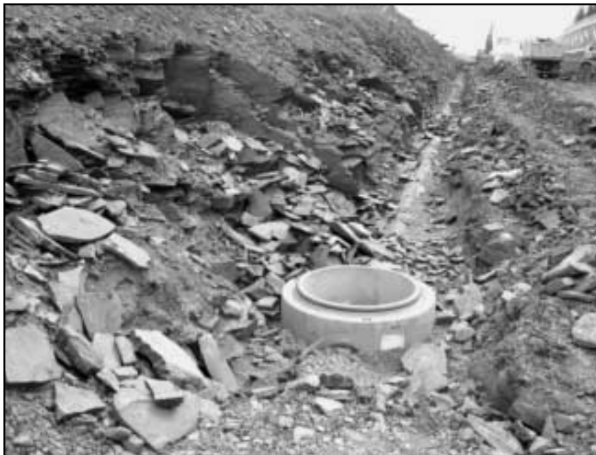
Abb. 7 : Wieder Ärger auf der Baustelle gegen Ende Juni 2006. Zum Leidwesen der Arbeiter wurde der Graben an verschiedenen Stellen zugewühlt, bevor die Rohre in das Sandbett eingerüttelt waren. Auf diesem Bild ist der Schaden teilweise schon wieder behoben gewesen.
